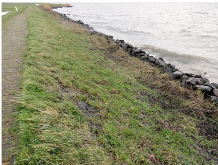
De dijk rond Marken is in een slechte conditie.
