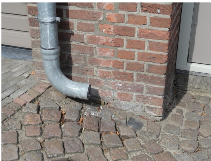
Figuur 4.1. Vooral bij de oudere panden gaat het regenwater vanaf de dakgoot niet direct de riolering in.
