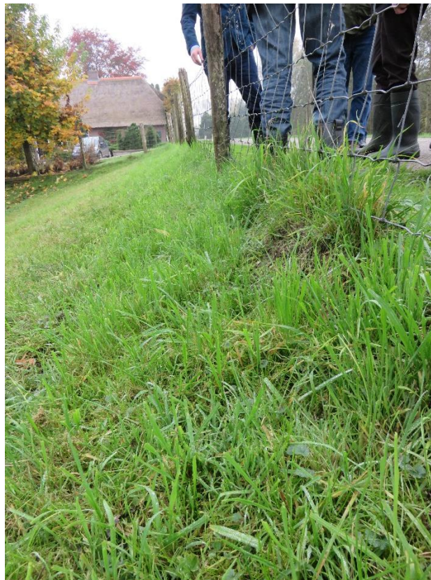
Figuur 13 Scheur in het talud.
